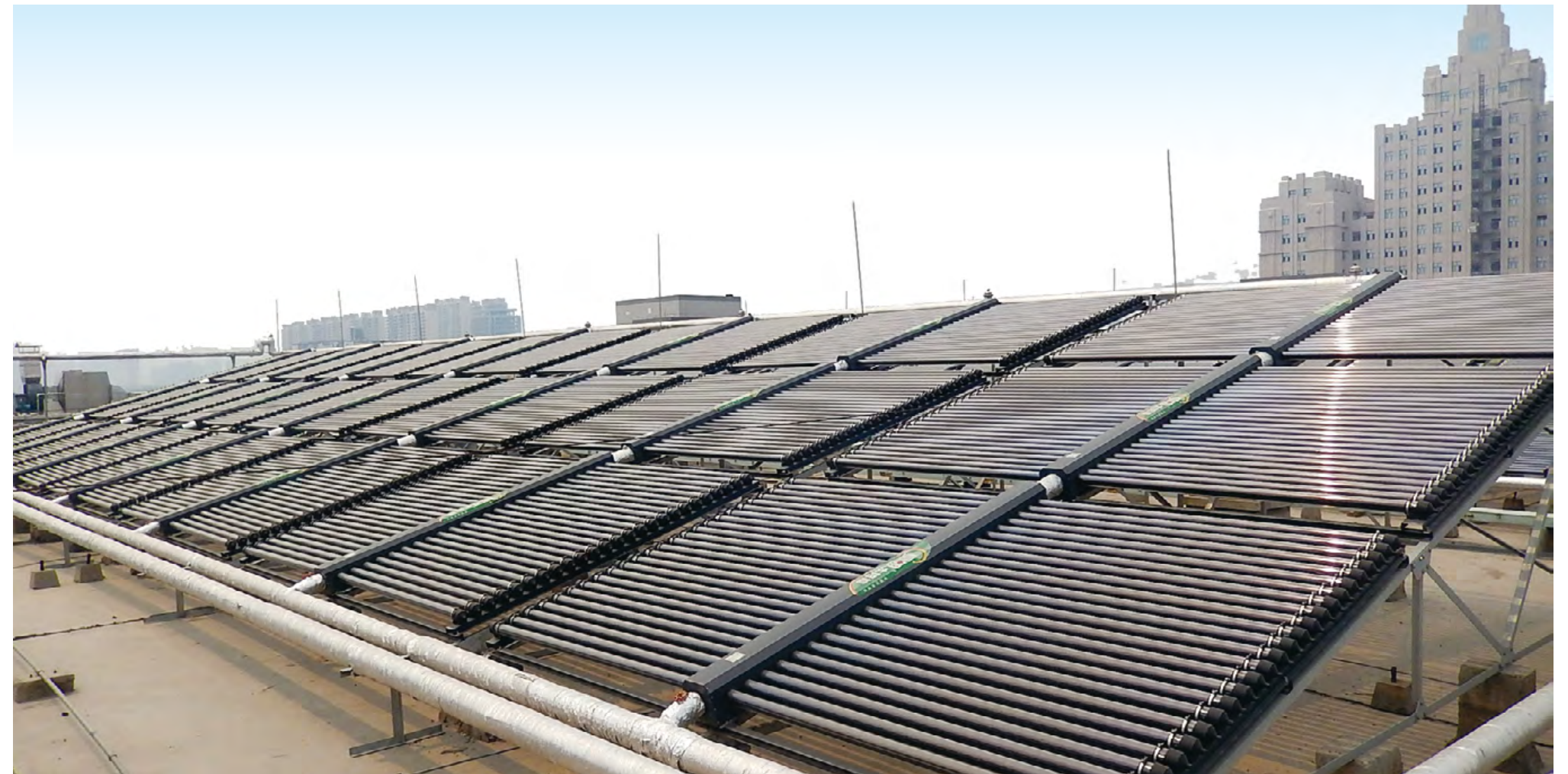
屋顶的空置面被覆盖上太阳能换热管与发电板用于换热和发电
