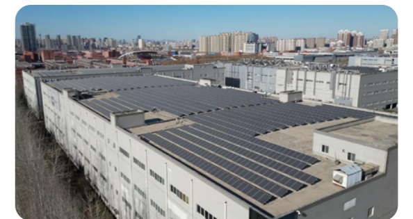
园区屋顶建设的光伏电站
