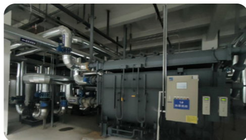
锅炉余热回收项目
