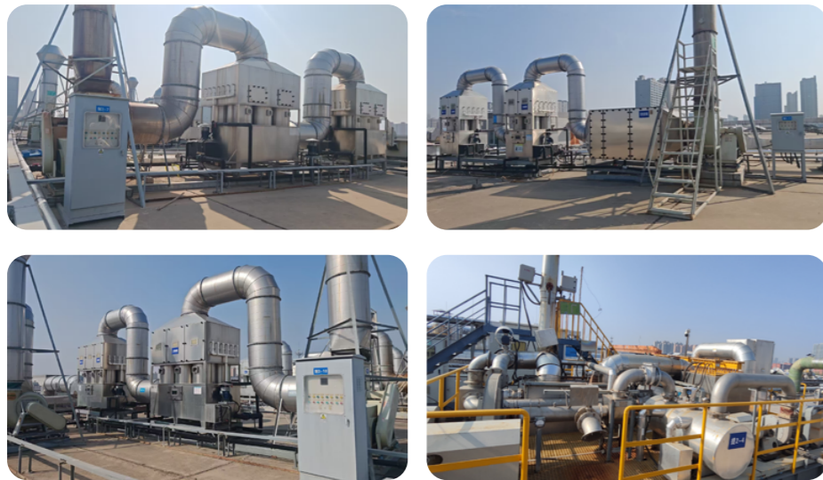
以岭药业废气处理设施
